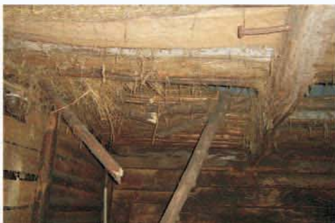
Zły stan techniczny budynków gospodarczych (fot. OR Warszawa)
