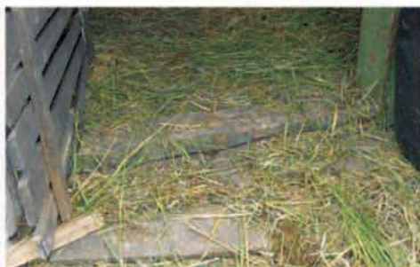
Zanieczyszczone paszą, nierówne przejście w budynku inwentarskim (fot. OR Rzeszów)
