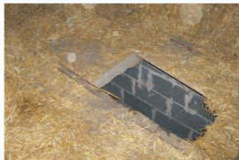
Brak zabezpieczeń otworów zrzutowych (fot. OR Lublin)
