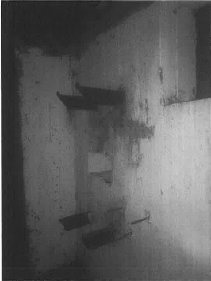
zdj. 7 – miejsce z wystającymi kształtownikami stalowymi
