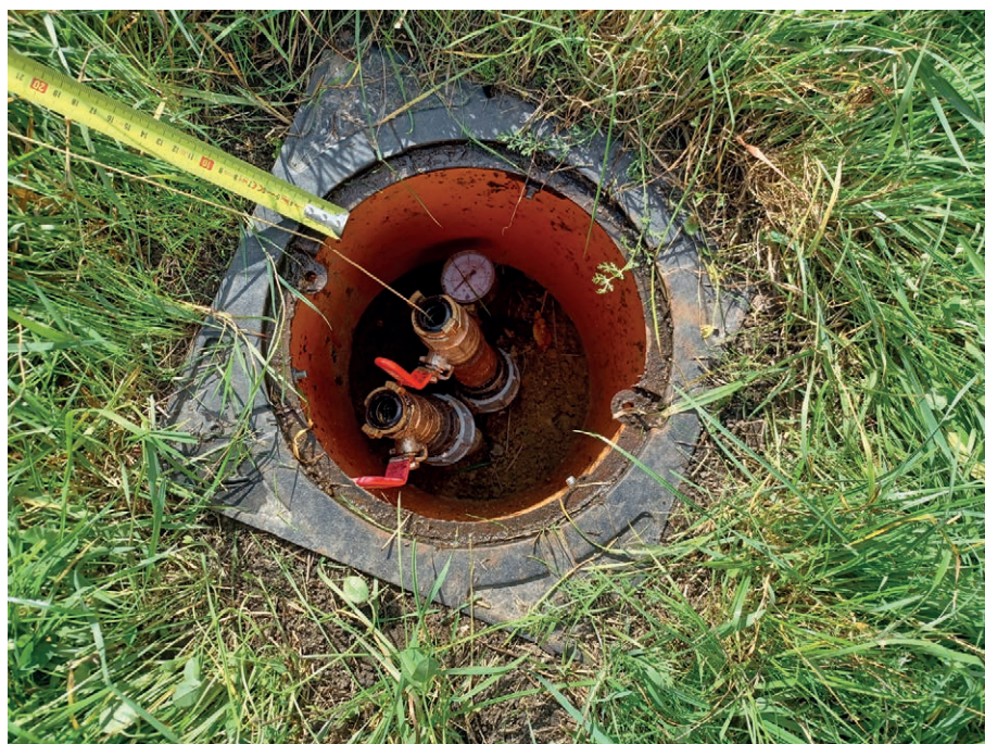
Ryc. 27. Obudowa termopiezometru TP-1 Wrocław
