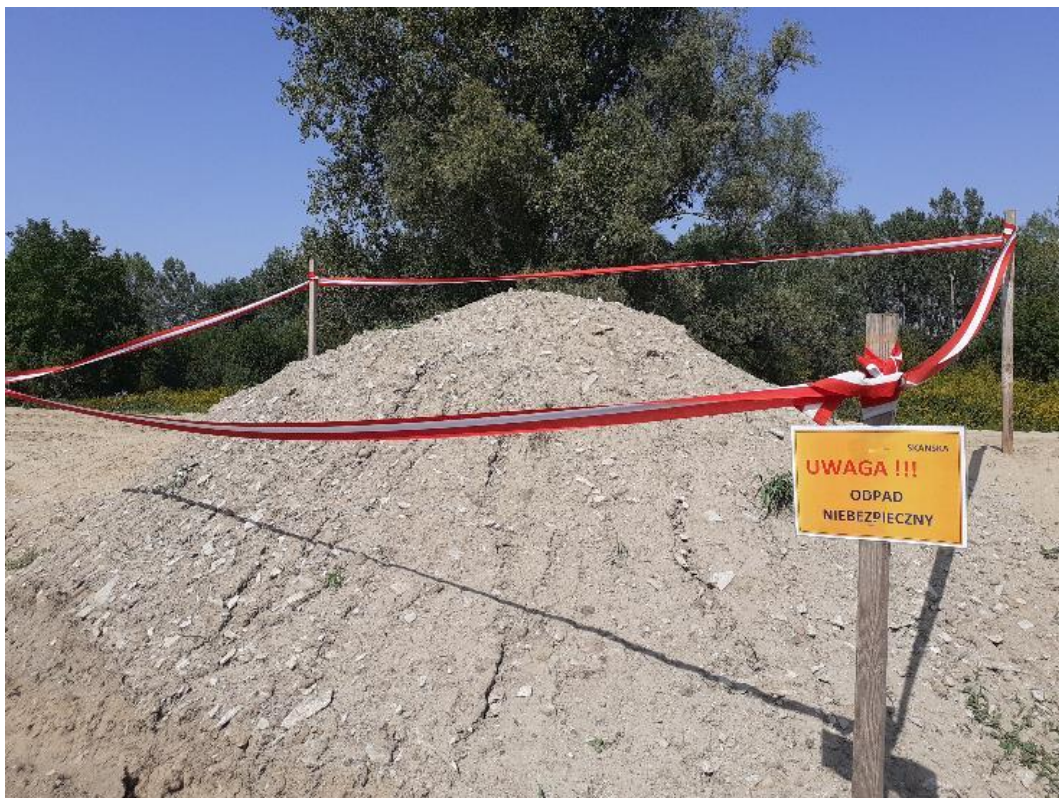
Fot. 11. Wał lewy, km ok. 1+100 – przykład oznakowania stref przetrzymywania odpadów odkrytych w trakcie prac ziemnych (ziemia zmieszana z fragmentami azbestu) (3. dekada sierpnia 2022 r.).
