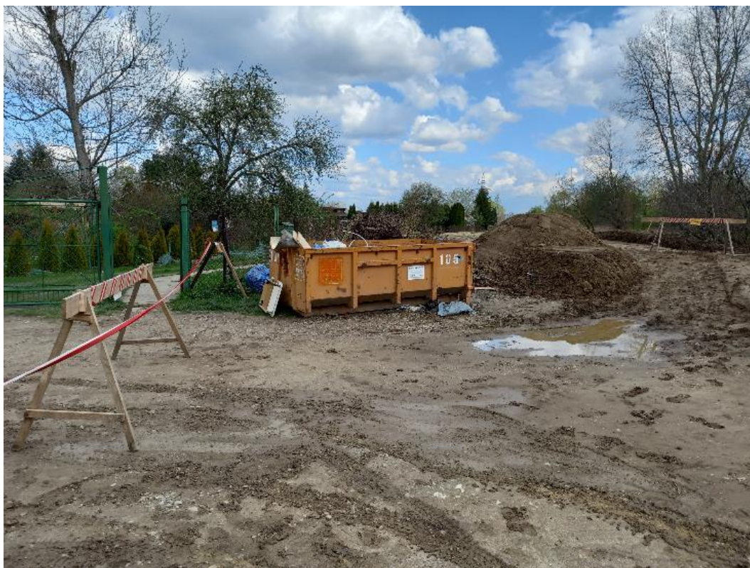
Fot. 10. Wał lewy, km ok. 3+800 – przygotowany kontener na śmieci – miejsce porzucania odpadów przez użytkowników Ogródków Działkowych „Jaskółka” (3. dekada kwietnia 2022 r.). Miejsce zostało oznaczone tablicami informującymi o zakazie wysypywania odpadów oraz monitorowaniu wizyjnym.
