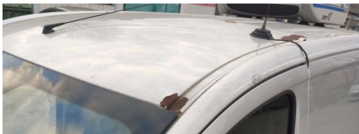
Korozja poszycia dachu
