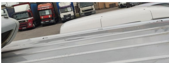
Poszycie dachu - zdeformowane
