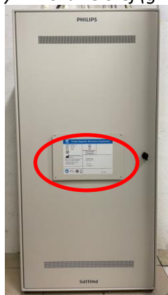
Ilustracja 1. Przednie drzwiczki głównej skrzynki rozdzielczej (gMDU).
