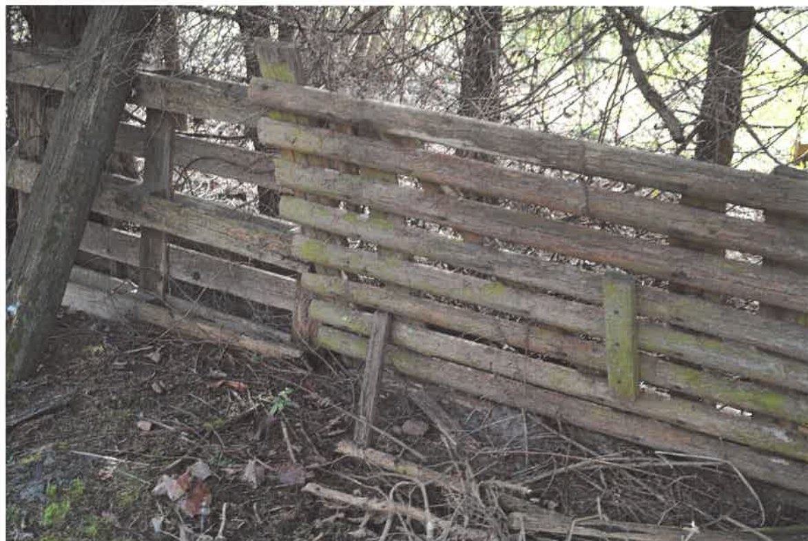
Uszkodzone ogrodzenie do demontażu
