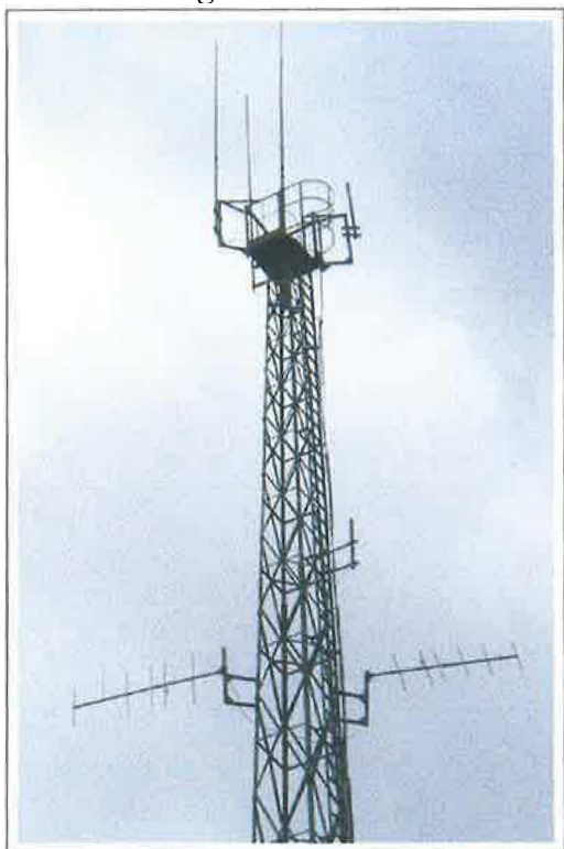
Fot. I. Podgórze - maszt 36 m
