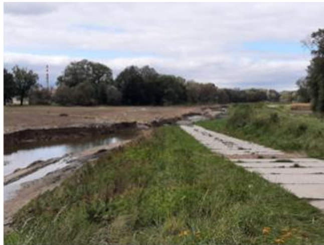
Rys. 19. Fotografia przedstawiająca szkody powstałe w wyniku powodzi z września 2024 r.
