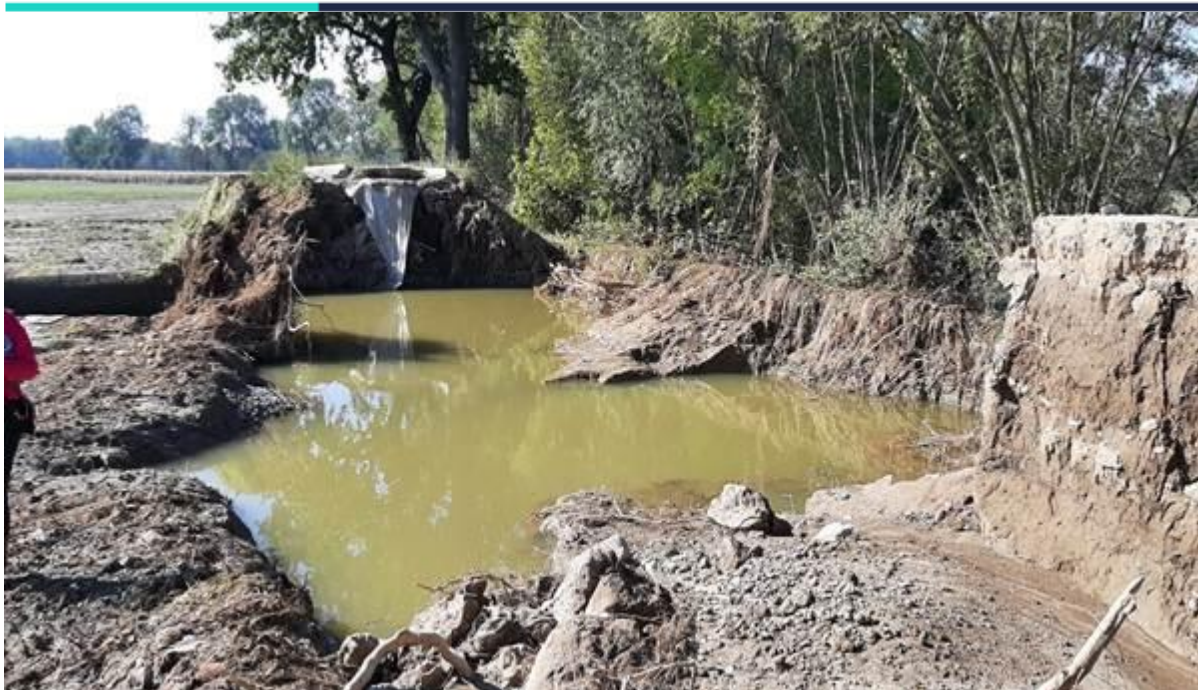
Rys. 13. Miejscowość Boboluski rz. Opawa uszkodzony wał przeciwpowodziowy w km 55+000 – 58+000
