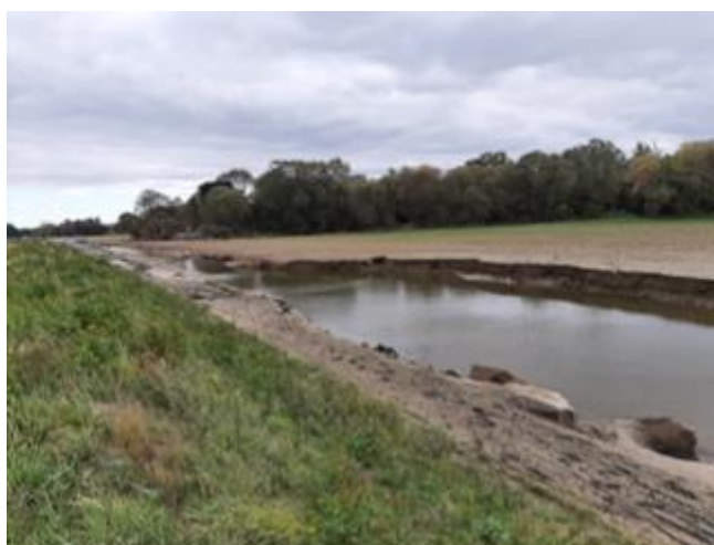
Rys. 20. Fotografia przedstawiająca szkody powstałe w wyniku powodzi z września 2024 r.
