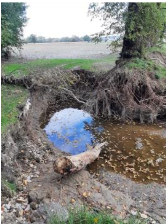
Rys. 17. Fotografia przedstawiająca szkody powstałe w wyniku powodzi z września 2024 r.
