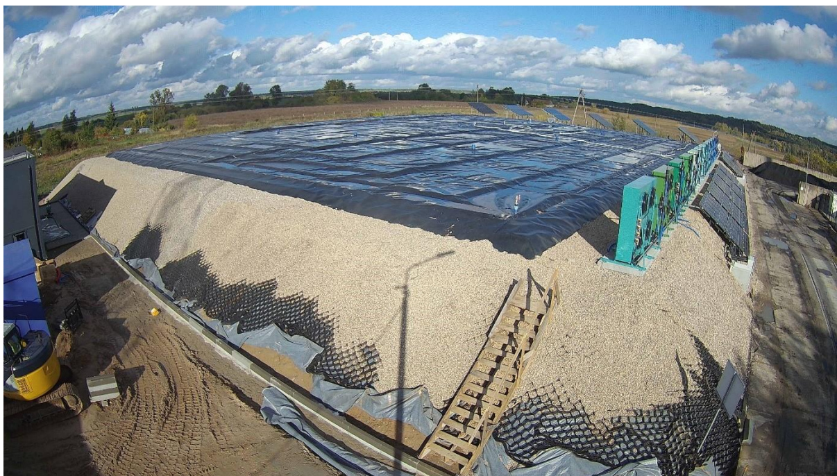
Rysunek 15. Zaizolowany wodny magazyn ciepła PTES. Października 2023
