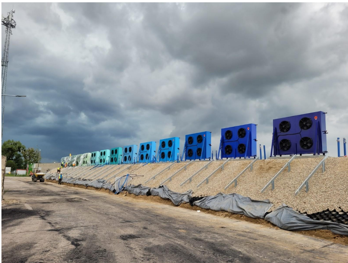
Rysunek 17. Powietrzne wymienniki ciepła zainstalowane na wale wodnego magazynu ciepła PTES.
