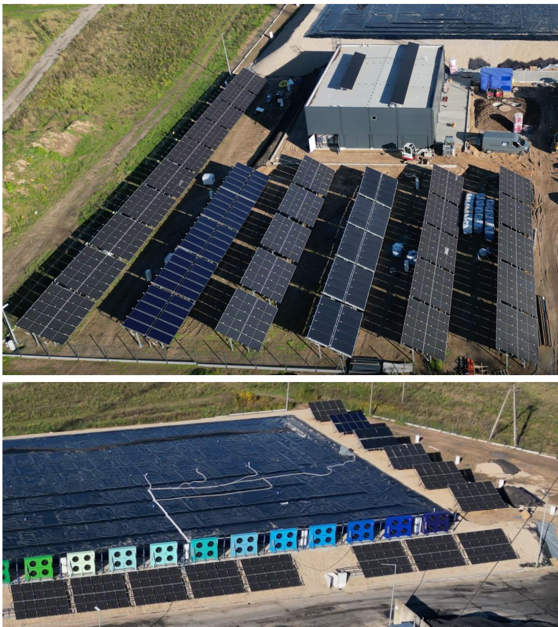
Rysunek 19. Hybrydowe kolektory słoneczne zainstalowane na wale wodnego magazynu ciepła.
