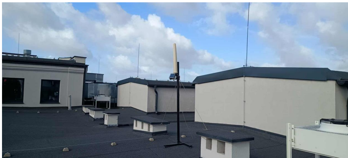
Rys. 2. Miejsce montażu SMS PEM – Urząd Miasta Poznania
