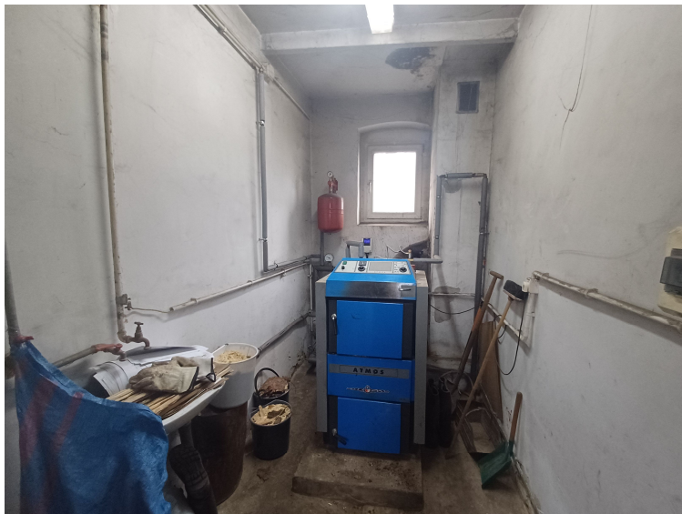
Zdjęcie nr 1 - Widok kotłowni Bobrzany 44
