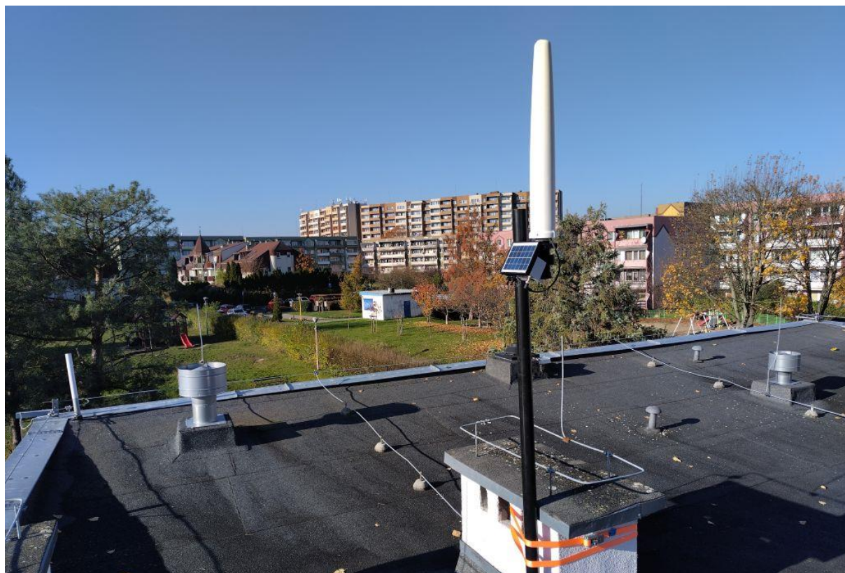
Rys. 2. Miejsce montażu SMS PEM – Przedszkole publiczne Nr 8 w Szczecinie
