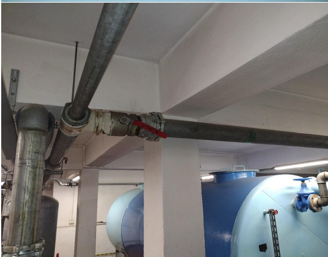
Fot. B_6 i B_7 Elementy hydroforni p.poż.
