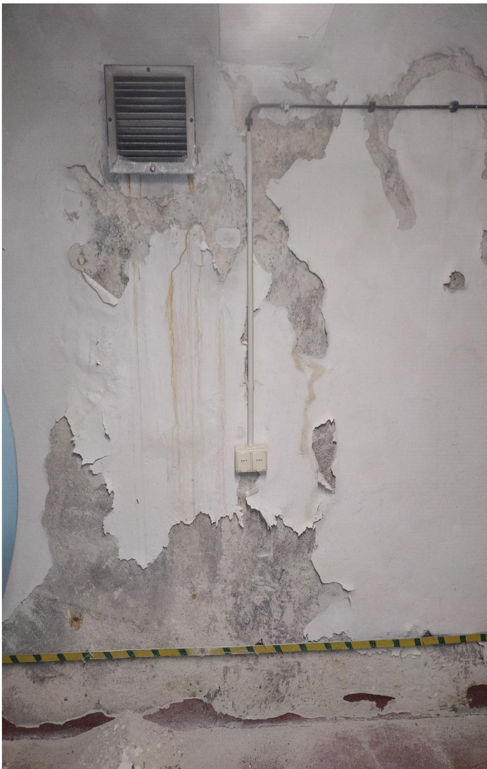
Fot. A_4 Wykwity wilgoci na ścianie żelbetowej
