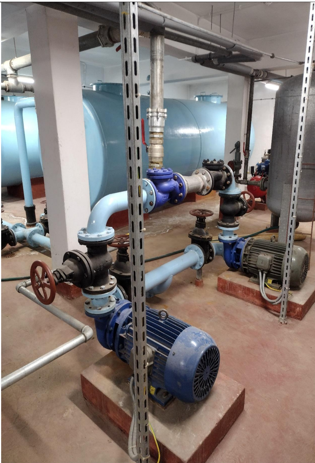
Fot. B_8 Zestaw pomp instalacji hydroforni p.poż.
