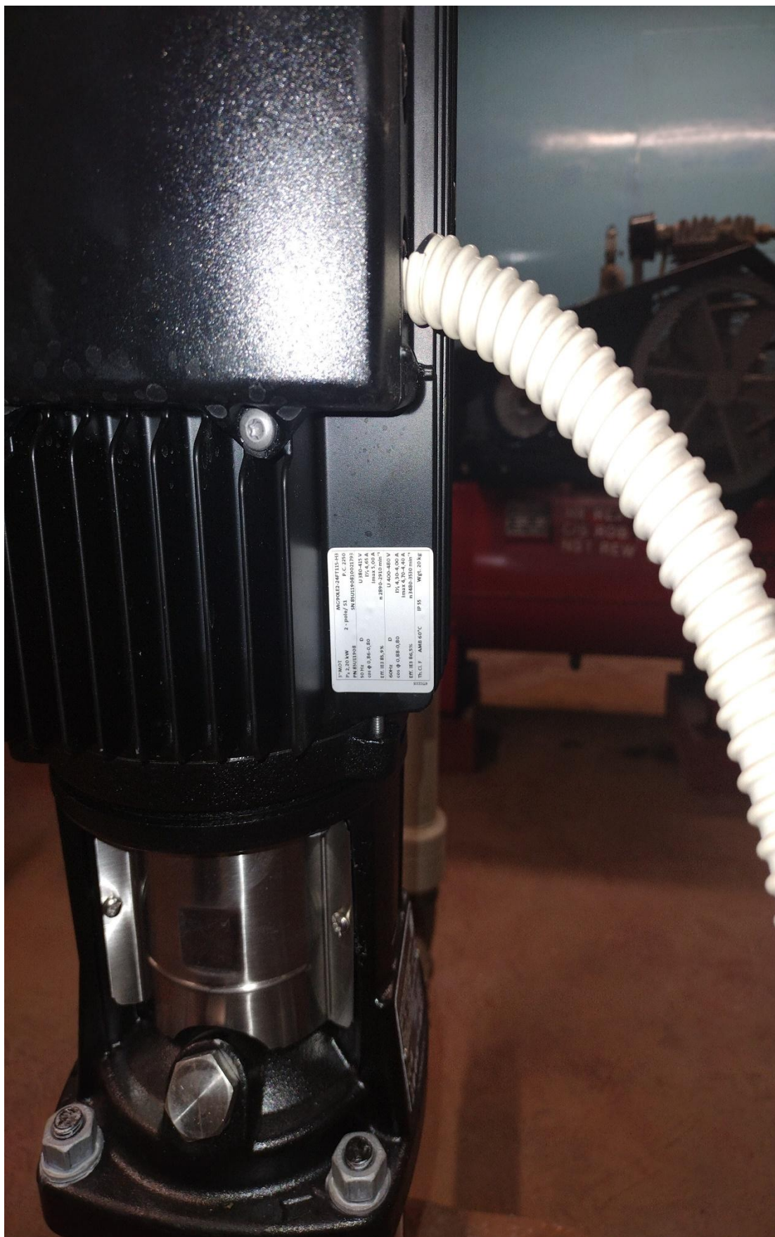
Fot. B_3 Pompa Grundfos (zestaw hydroforowy wody bytowej)
