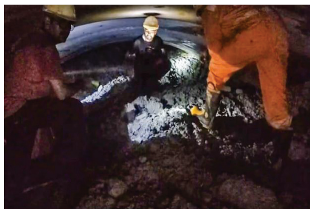
► Rys. 4. Poszukiwanie szczątków ludzkich w zawale ► Fig. 4. Search for human remains in the tunnel collapse
