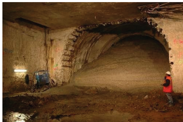
► Rys. 12. Widok rejonu czoła przodka po wystąpieniu przebiccia hydraulicznego
