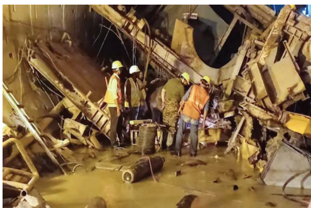
► Rys. 3. Działania ratownicze w rejonie zawalu ► Fig. 3. Rescue operations in the collapse zone
