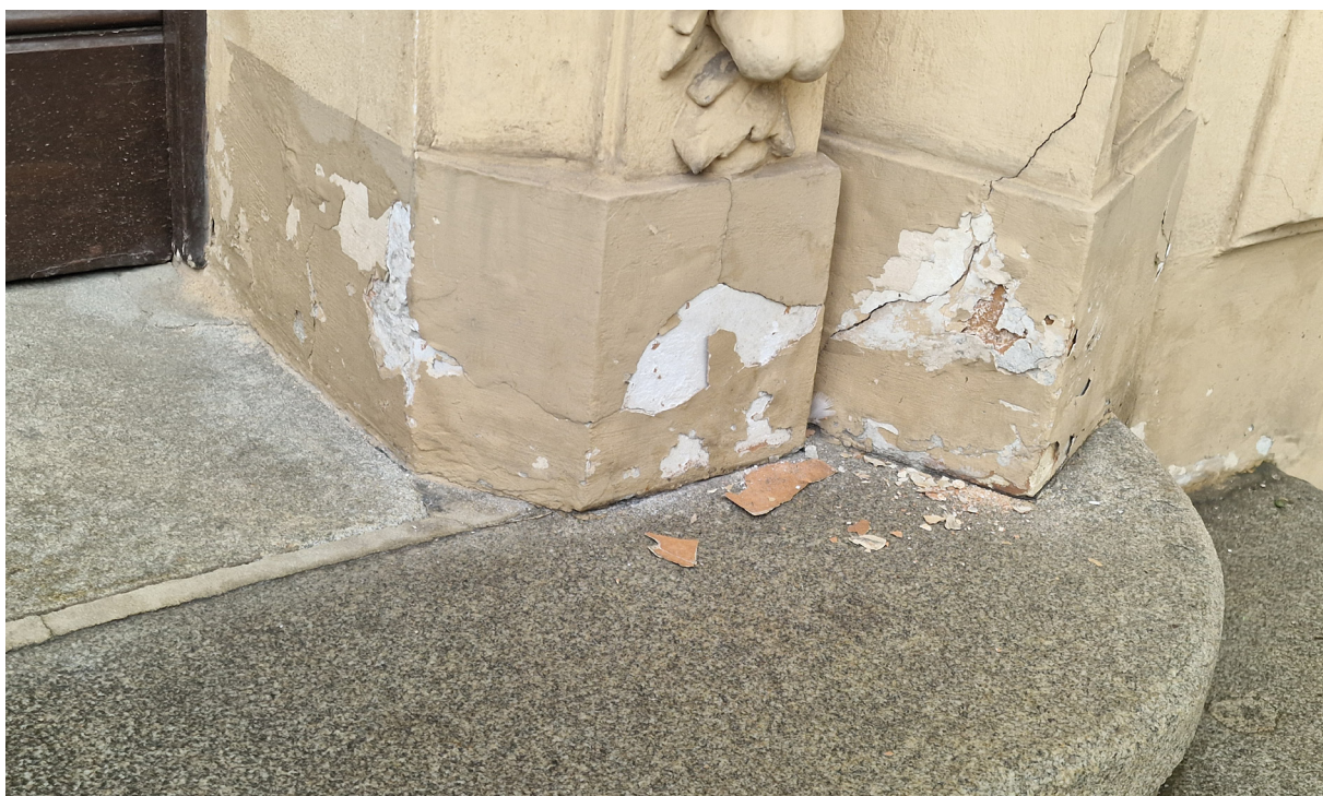
Fot. Nr 5, 6 Taras i parter budynku Instytutu Ekspertyz Sądowych w Krakowie, przy ul. Westerplatte 9 w Krakowie. Detale parteru budynku, widoczne odspojone malatury, spękanie tynki.
