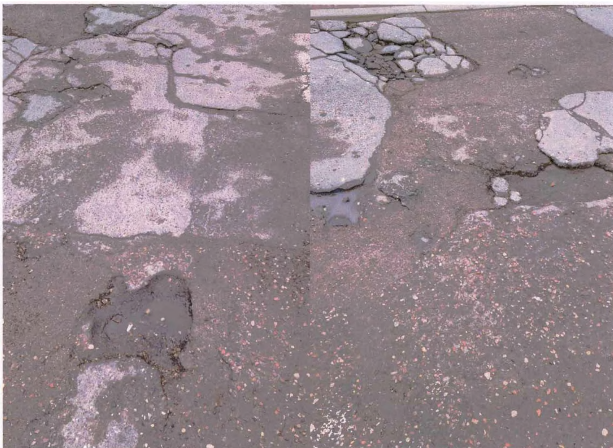
Dziury mieszczące się na drodze pod stacją PKP w Mińsku Mazowieckim. Jest ich znacznie więcej, jeśli będzie potrzeba mogę wszystkie udokumentować. (zdjęcie własne wykonane w dniu 1 lutego 2025 r.)
