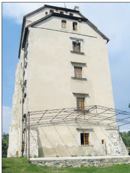
39. Wojciechów, wieża ariańska, stan przed remontem elewacji pld., fot. M. Kurczewicz, 2010
