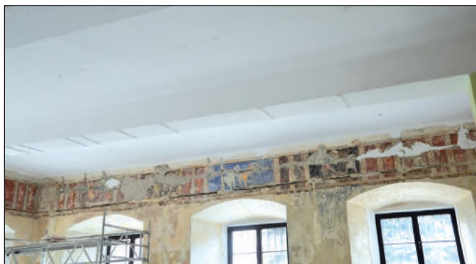
3. Lublin, klasztor pobrygidkowski (obecnie siedziba Zgromadzenia Sióstr Urszulanek UR), polichromia znajdująca się w sali gimnastycznej, przed konserwacją, fot. B. Stolarz, 2019
