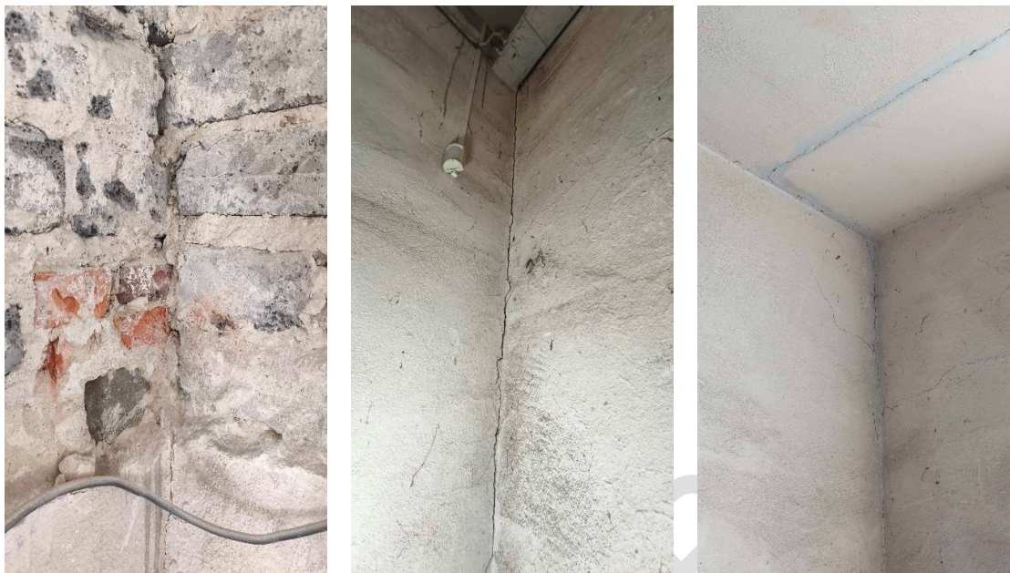
Rys. Zarysowania powstałe na styku ściany wewnętrznej z zewnętrzną
