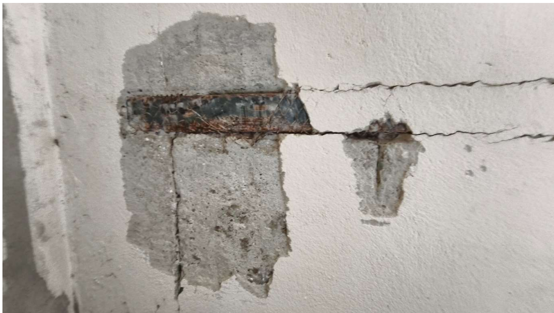
Fot. Uszkodzenia stropu – zarysowania. Odkrywka od dołu.
