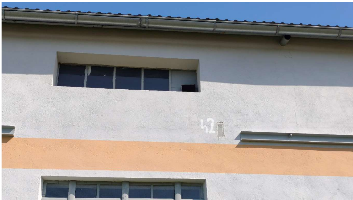
Fot. Uszkodzenia na elewacji oraz ściagi stalowe
