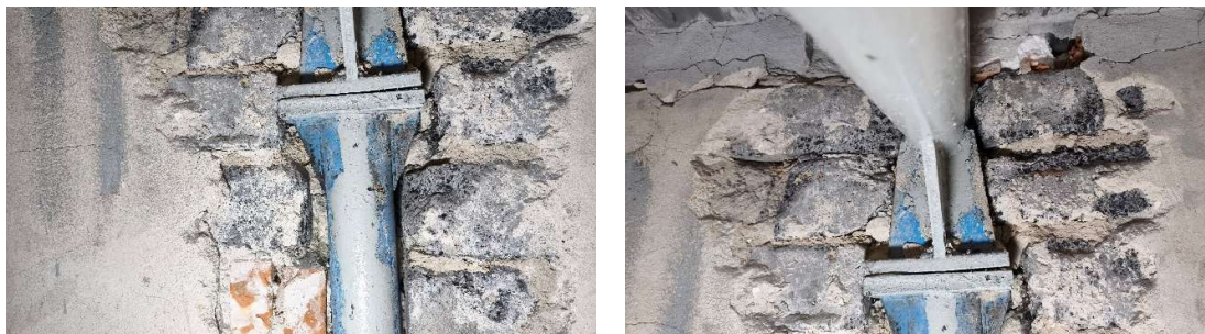
Fot. Zarysowania w poziomie poddasza, pomiędzy słupem stalowym, a ścianą
