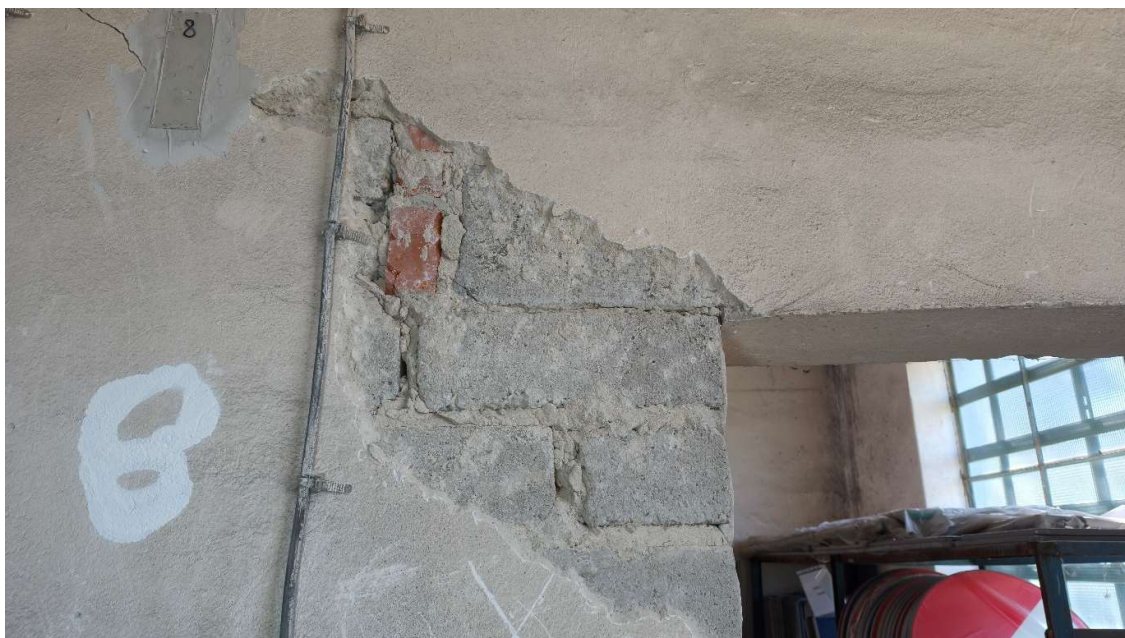
Fot. Uszkodzenia ścian – zarysowania
