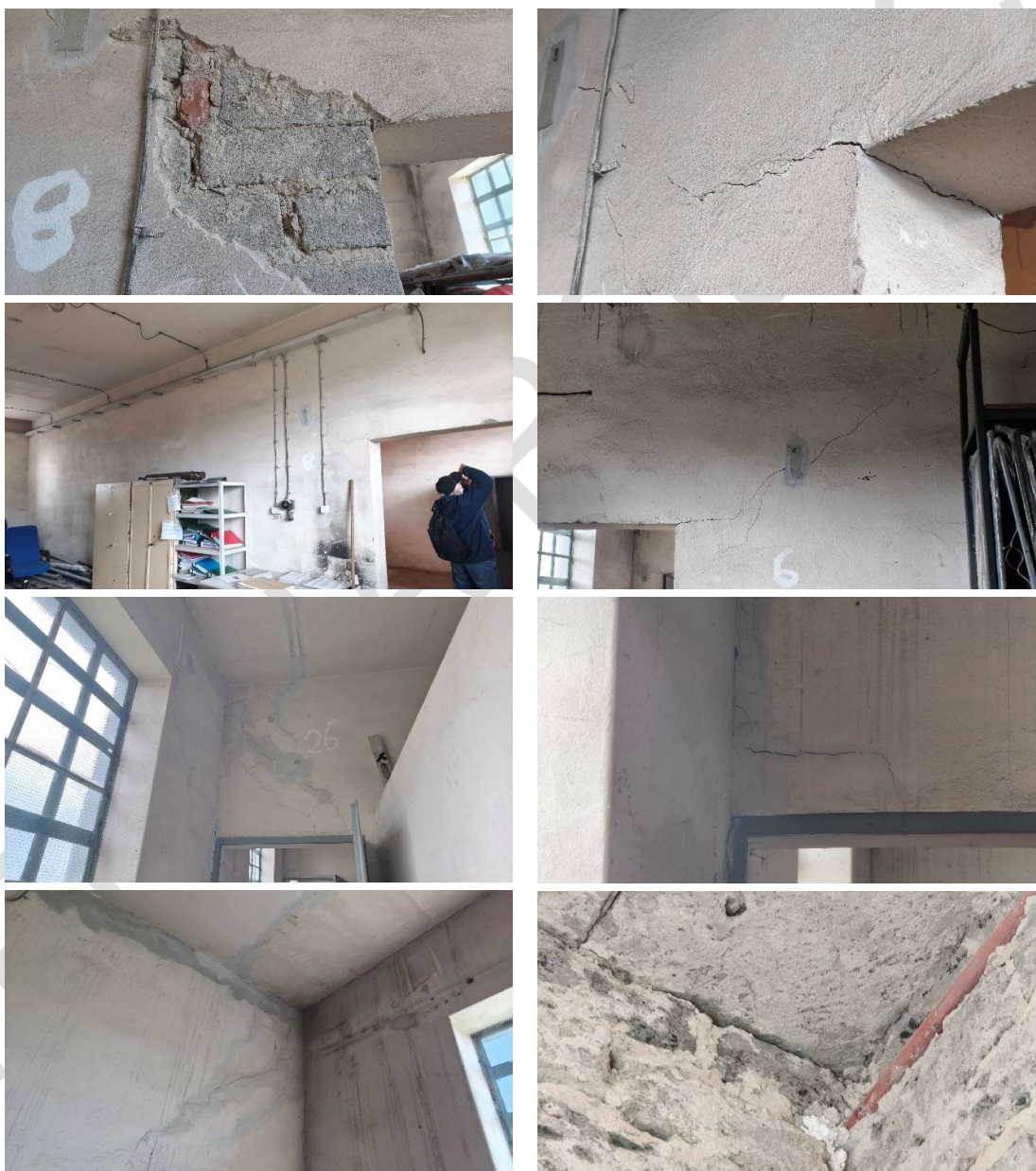
Rys. Zarysowania ukośne na ścianie wewnętrznej
