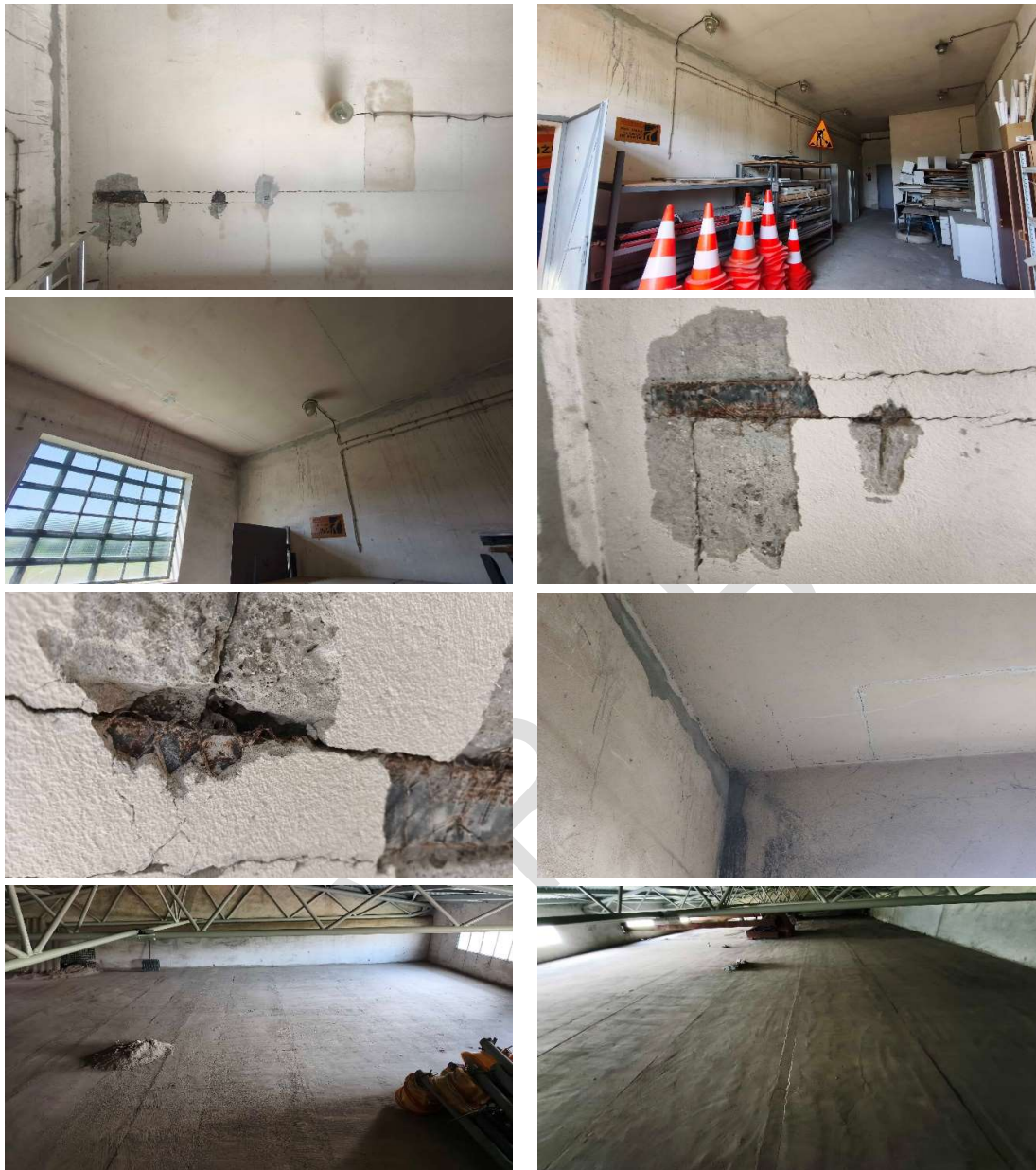
Fot. Zarysowania stropu gęstożebrowego
