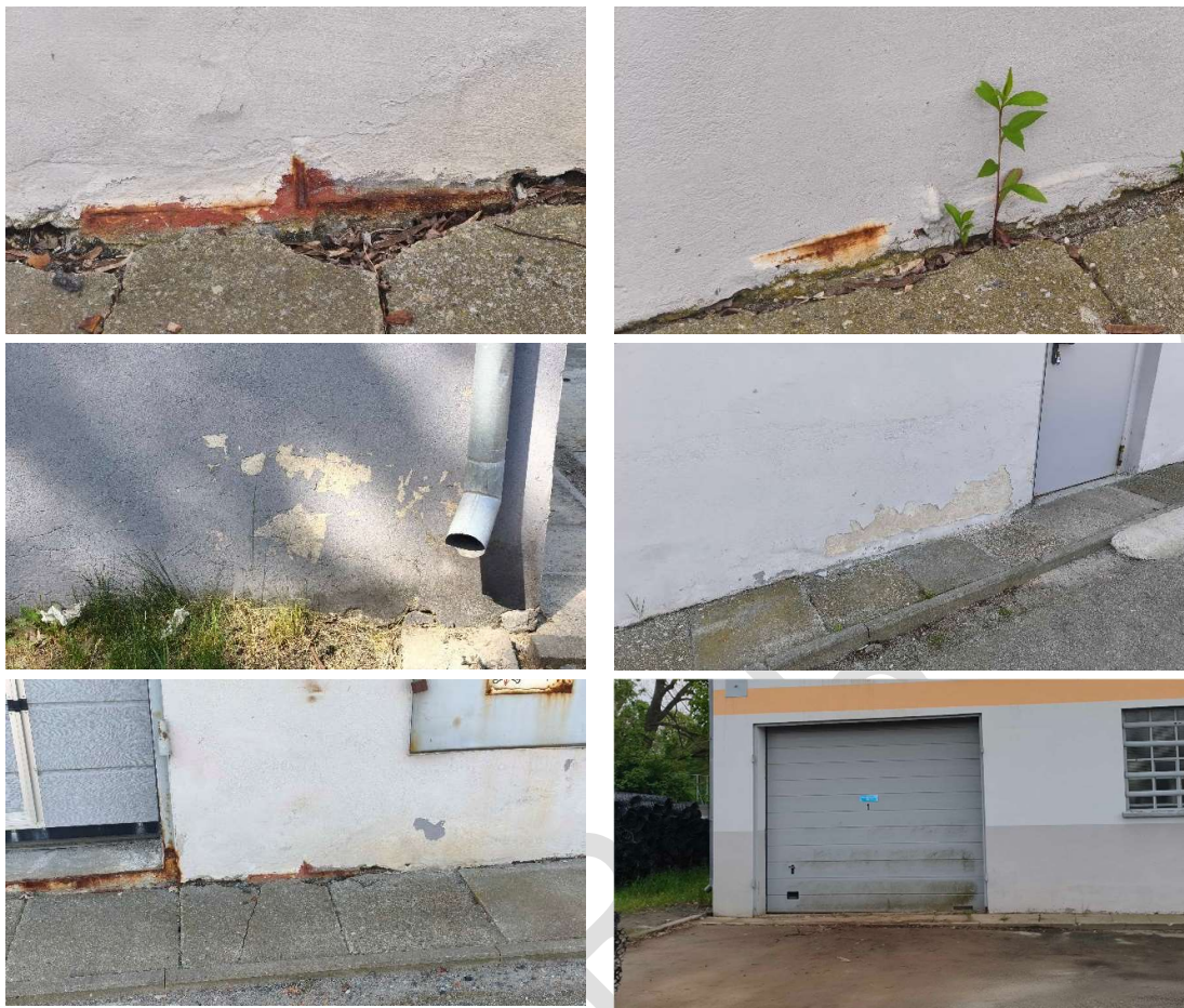
Fot. Uszkodzenia muru spowodowane zawilgoceniem
