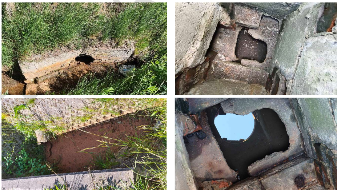
Fot. Zbiorcza rura kanalizacji deszczowej przebiegająca pod obiektem
