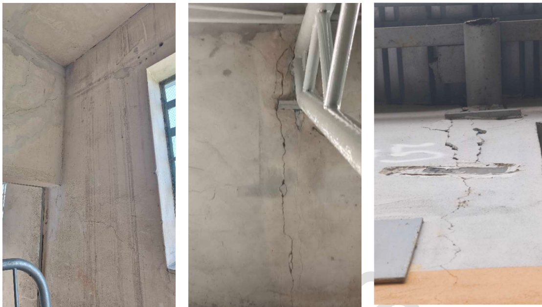
Fot. Zarysowania pionowe w miejscach słupów stalowych
