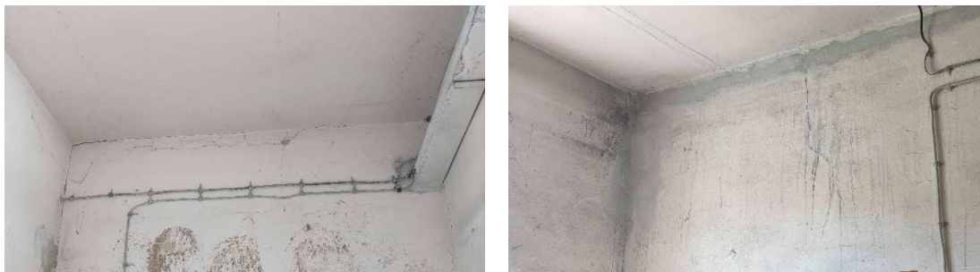
Rys. Zarysowania powstałe na styku ściany ze stropem
