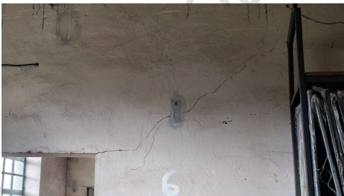
Fot. Uszkodzenia ścian – zarysowania
