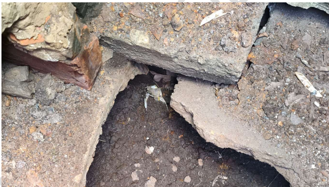
Fot. Uszkodzona kanalizacja deszczowa
