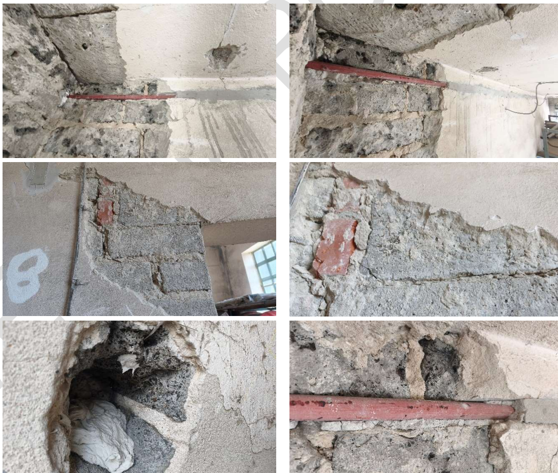
Fot. Odkrywki ścian murowych z pustaka żużlobetonowego wraz z widocznymi zarysowaniami
