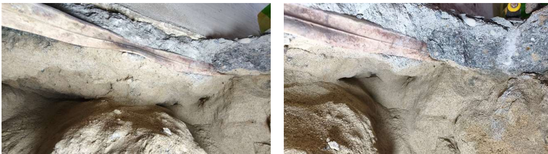
Fot. Odkrywka nr 1 – Posadzka – Widoczny brak ławy fundamentowej pod posadzką w miejscu ściany poprzecznej
