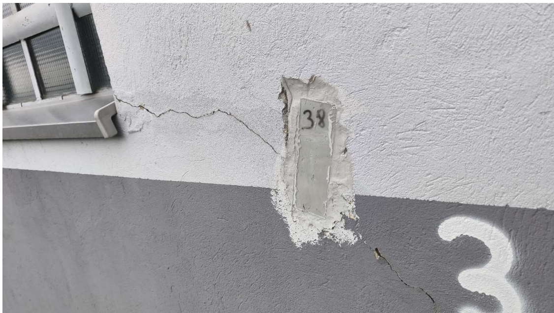
Fot. Uszkodzenia ścian – zarysowania
