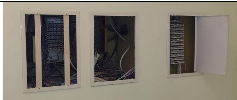
Przełącznica telefoniczna budynek A izolotka Parter
