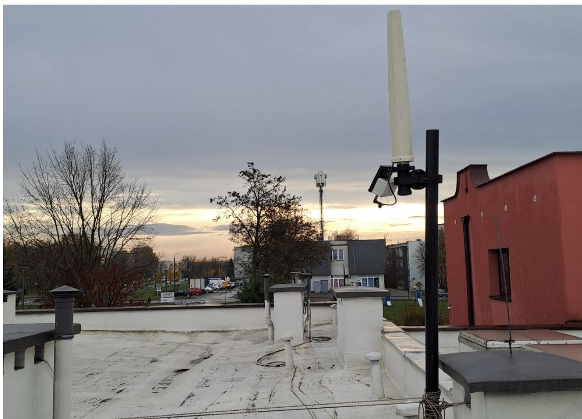
Rys. 2 Miejsce montażu SMS PEM – Jubilat – Dom Kultury, Tarnowskie Góry – widok na SBTK
