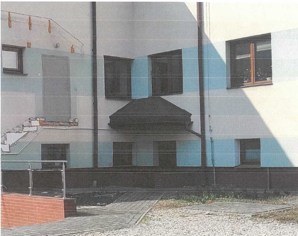
Daszek do rozbiórki nad wejściem do magazyn
