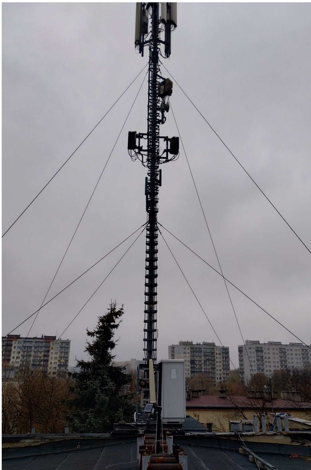
Rys. 4 Miejsce montażu SMS PEM – SP nr 3 w Sosnowcu – widok na SBTK
