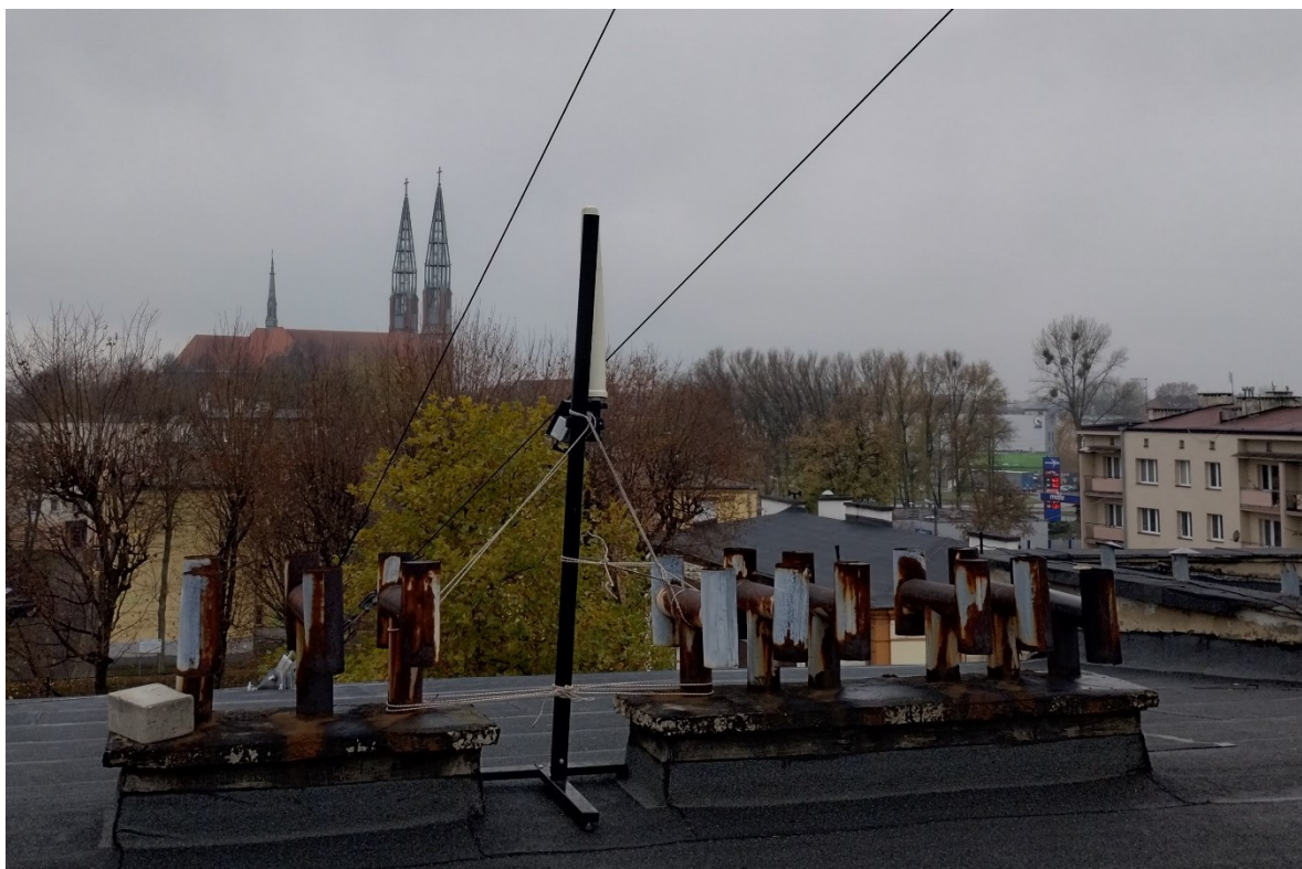
Rys. 2 Miejsce montażu SMS PEM – SP nr 3 w Sosnowcu
