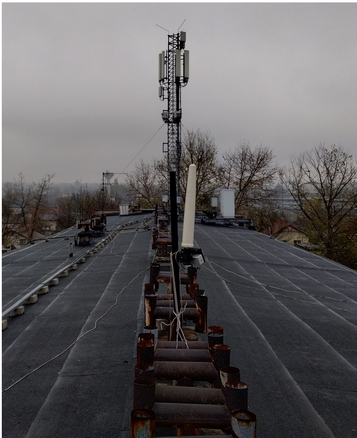
Rys. 3 Miejsce montażu SMS PEM – SP nr 3 w Sosnowcu – widok na SBTk
