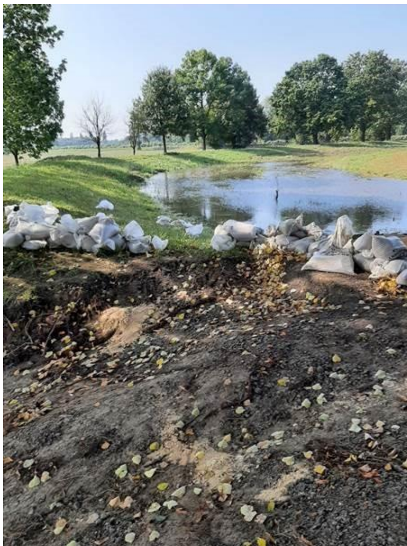
Rys. 8 Uszkodzona korona wału przeciwpowodziowego w m. Ligota przy ul. Burzej, rz. Iłownica
