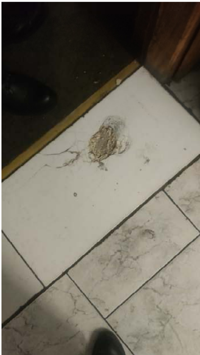
Ubytki płytek ceramicznych w posadzce.
