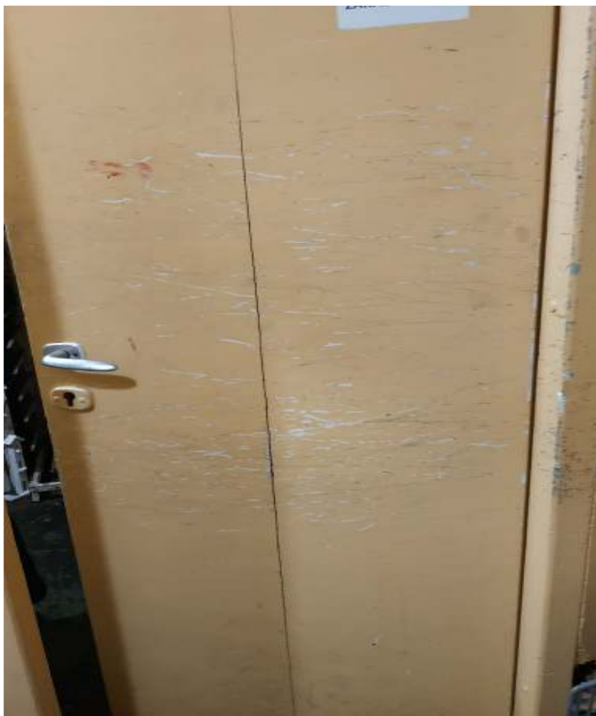
Zniszczone, uszkodzone drzwi w obiekcie obrotu żywnością.
