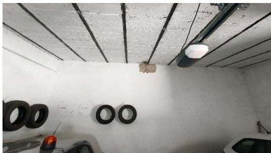
Fot. Zarysowania pod belkami stalowymi
