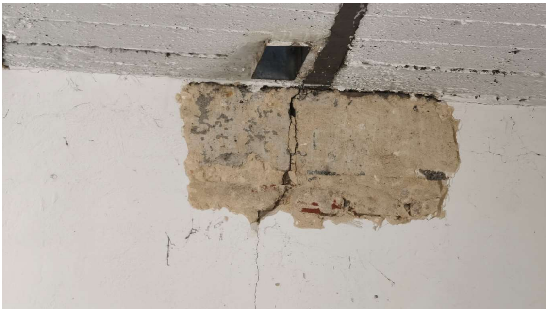
Fot. Uszkodzenia ściany w garażu
