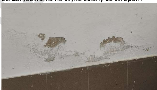
Fot. Zawilgocenia ściany murowej
