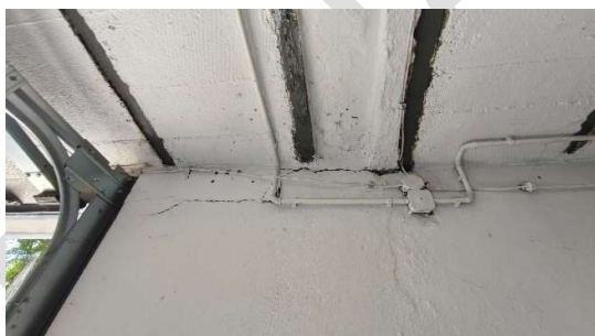
Fot. Zarysowania na styku ściany ze stropem
