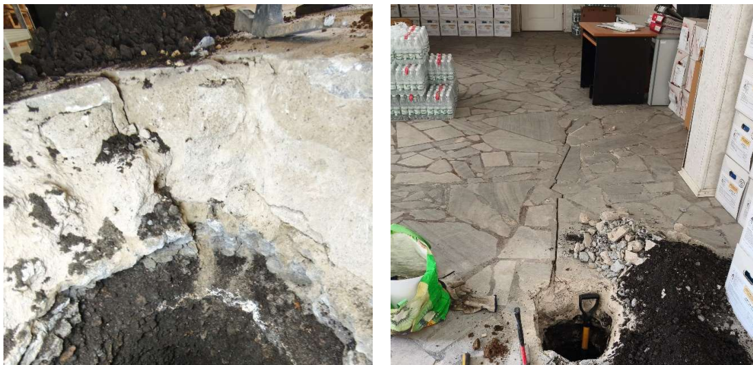
Fot. Przebieg szczeliny przez warstwy płyty na gruncie. Widoczny otwór badawczy w podłożu posadzki
