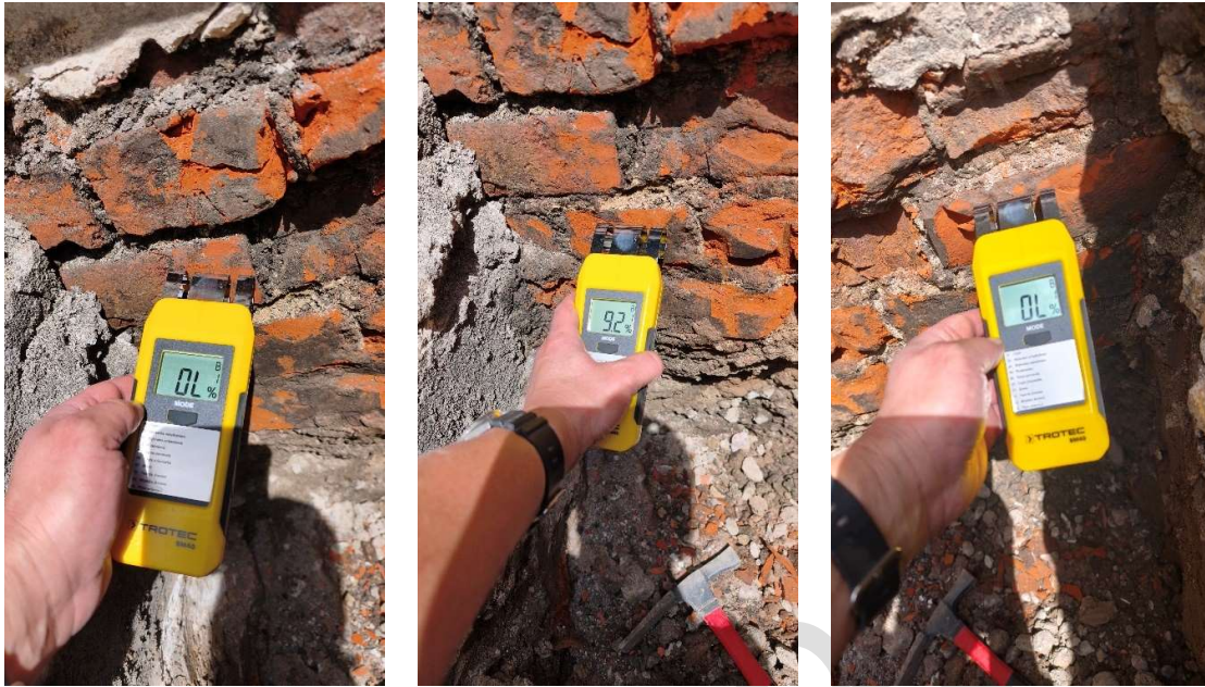
Fot. Pomiar wilgotności ławy fundamentowej poniżej poziomu posadowienia – wynik: ściana jest mokra lub silnie zawilgocona. ('0L' oznacza wilgotność >20%)
