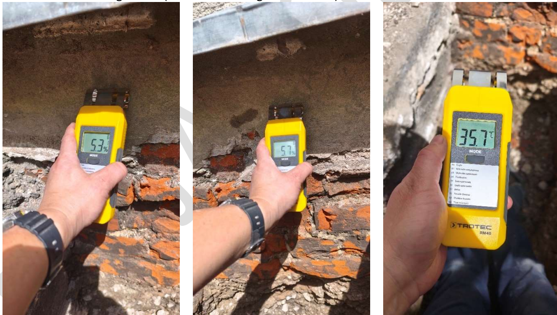
Fot. Pomiar wilgotności ławy fundamentowej w części powyżej poziomu terenu – wynik: ściana jest lekko zawilgocona
