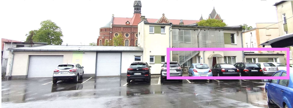
Fot. Zaznaczona część budynku – świetlica z porysowaną posadzką – przedmiot opracowania
