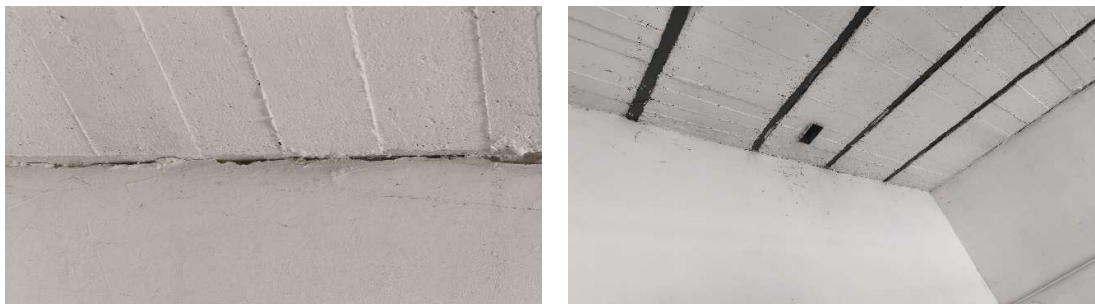
Fot. Zarysowania na styku ściany ze stropem
