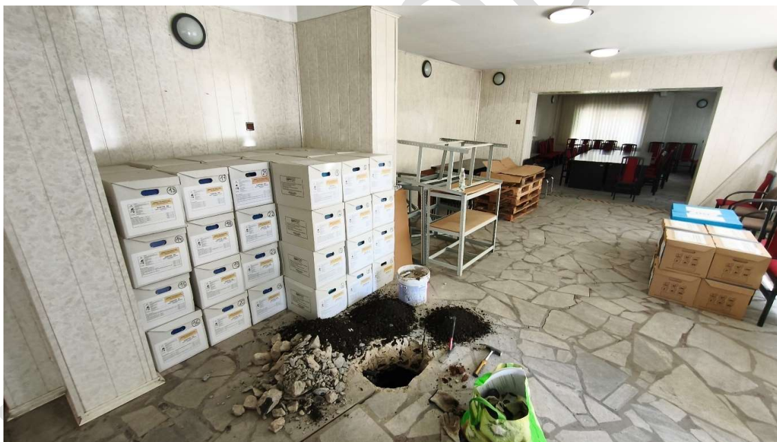
Fot. Uszkodzona posadzka. Widoczna odkrywka
