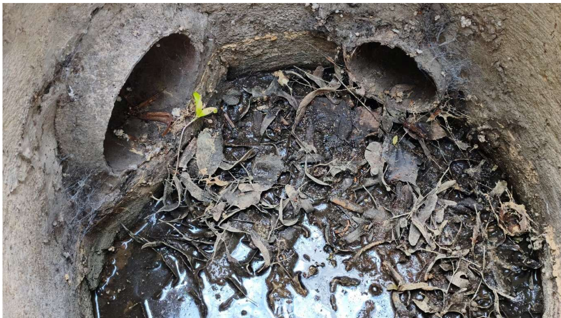
Fot. Częściowo niedrożny system kanalizacji deszczowej
