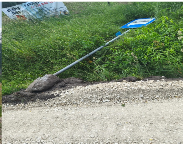
Zdjęcie nr 2 przewrócony znak D-15 (przystanek autobusowy)
