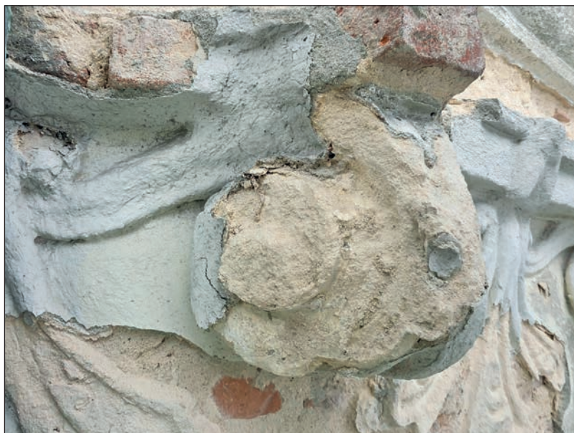
3. Detal elewacji, stan przed pracami, fot. M. Filip
