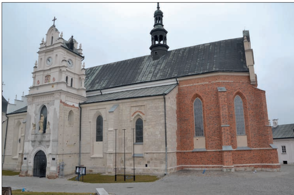
5. Widok kościoła po wykonaniu prac przy nadbudowanej wieży kruchty, fot. B. Stolarz, 2013
