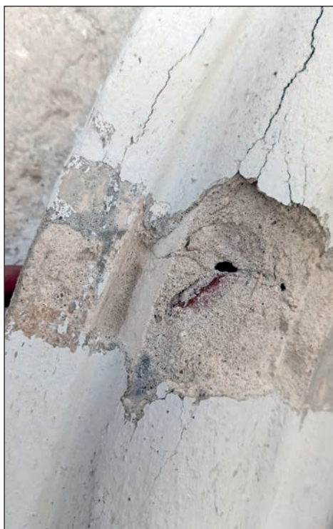
4. Detal elewacji, stan przed pracami, fot. M. Filip
