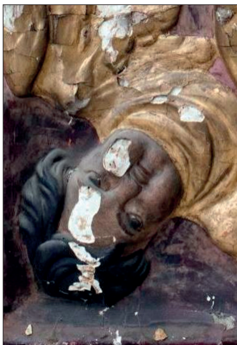
Il. 8. Lewy dolny narożnik płaskorzeźby z widocznymi ubytkami zaprawy, warstwą kurzu i brudu na powierzchni. Fot. P. Gąsior.
