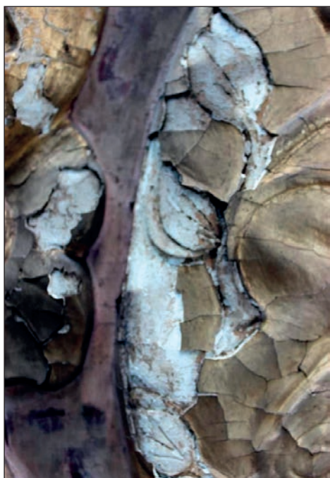
Il. 7. Fragment dekoracji ze znacznie popękana i odspajającą się zaprawą. P. Gąsior
