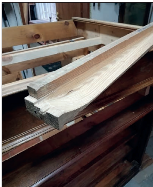
8. Szafka środkowa nadstawy. Uszkodzenia widoczne po zdemontowaniu przewodnic, fot. P. Hapka
