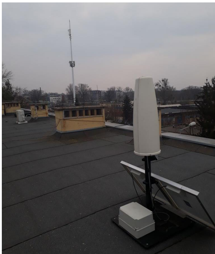
Rys. 2 Miejsce montażu SELMS PEM – It-PIB we Wrocławiu – widok na SBTk
