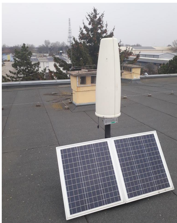
Rys. 3 Miejsce montażu SELMS PEM – It-PIB we Wrocławiu – widok na SBTk
