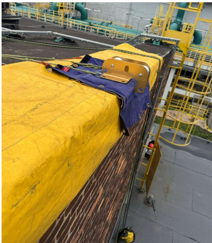
Fot. 14. Podwójne zabezpieczenie krawędzi
