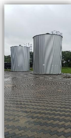
Zdjęcie 4) Zbiorniki do gromadzenia wody uzdatnionej
