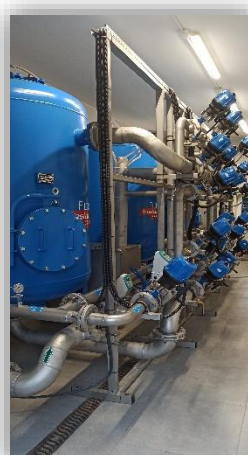
Zdjęcie 3) System filtrów uzdatniających wodę
