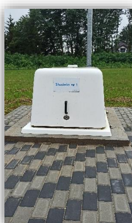
Zdjęcie 2) Studnia głębinowa z obudową naziemną
