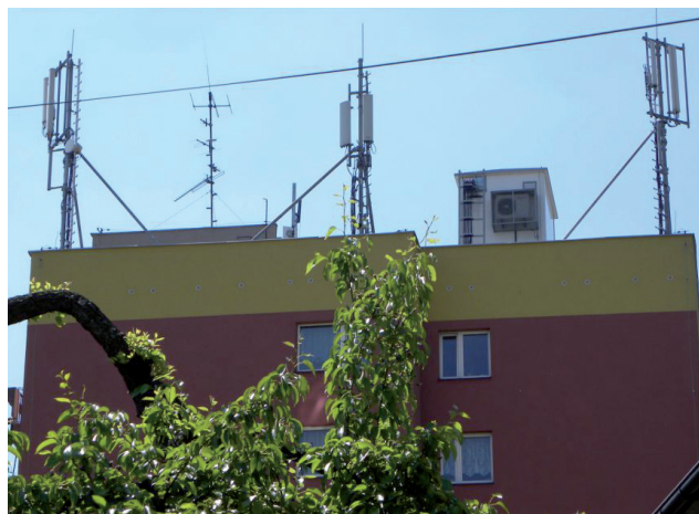
Fot. 4. Stacja bazowa telefonii komórkowej na budynku mieszkalnym
