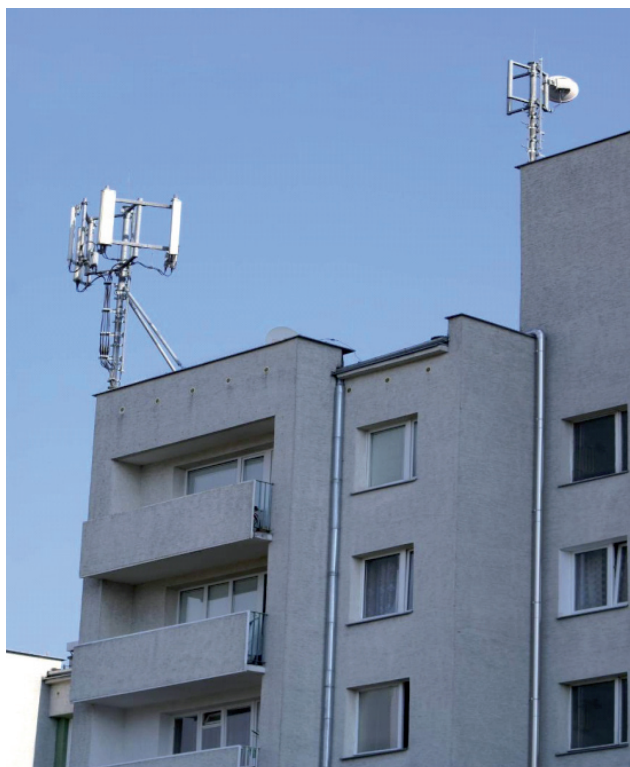
Fot. 2. Stacja bazowa – „na istniejącej budowlie”
