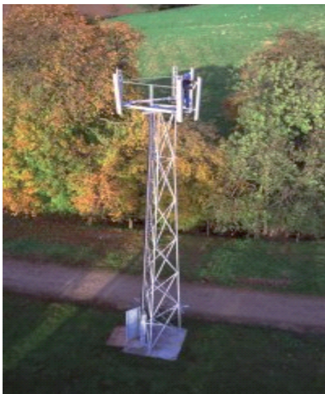
Fot. 1. Stacja bazowa – „wieżowa”
