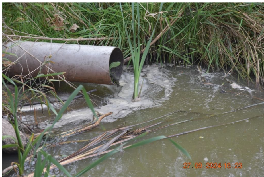
Zdjęcie 11. Jeden z wylotów kanalizacji deszczowej
