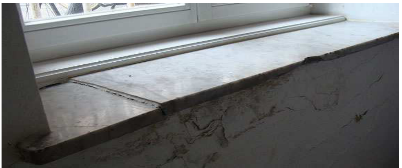
▲ Wadliwe naprawy łączeń płyt parapetu – na zdjęciu okno w pomieszczeniu piwnic
