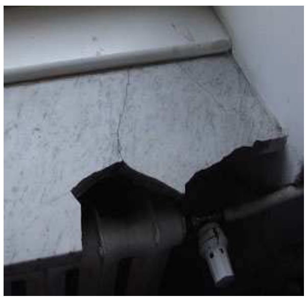
▲ Zniszczenia spowodowane prawdopodobnie w trakcie prac instalacyjnych
