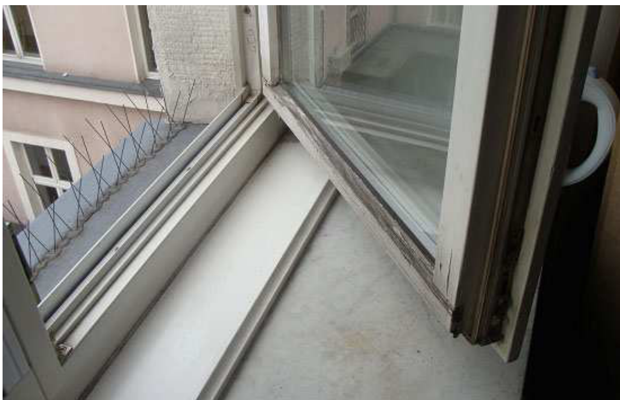
▼ Okno II piętra od strony dziedzińca gospodarczego, zniszczenie powłoki malarskiej powoduje destrukcję drewna.
