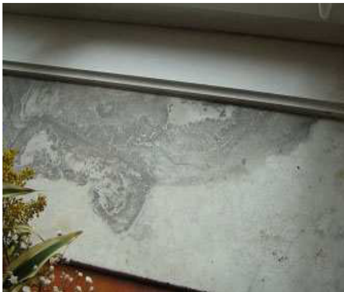
▲ Przykłady uszkodzeń preparatami chemicznymi
