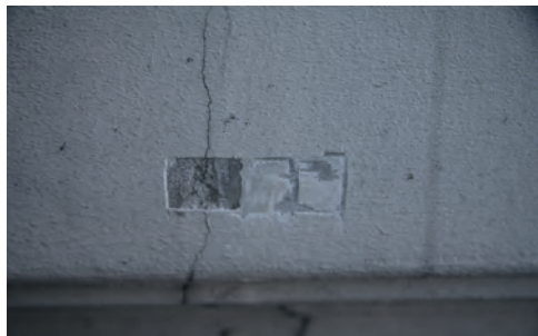
3 c. Odkrywka nr 2. Zbliżenie. Pod warstwą malatury wtórnej widoczne resztki oryginalnej warstwy malarskiej w kolorze błękitu oraz oryginalny tynk w kolorze szarym Test pit no. 2 - close-up. Under the secondary paint layer, remnants of the original paint layer in blue and the original grey plaster are visible
