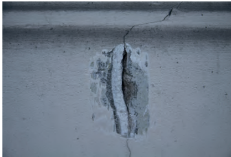
4 c. Miejsce wykonania odkrywki nr 3. Zbliżenie. Widoczne jest głębokie pęknięcie strukturalne muru Location of test pit no. 3 - close-up. A deep structural crack in the wall is visible
