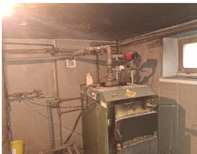
Fot. 2 Kocioł na paliwo stałe
