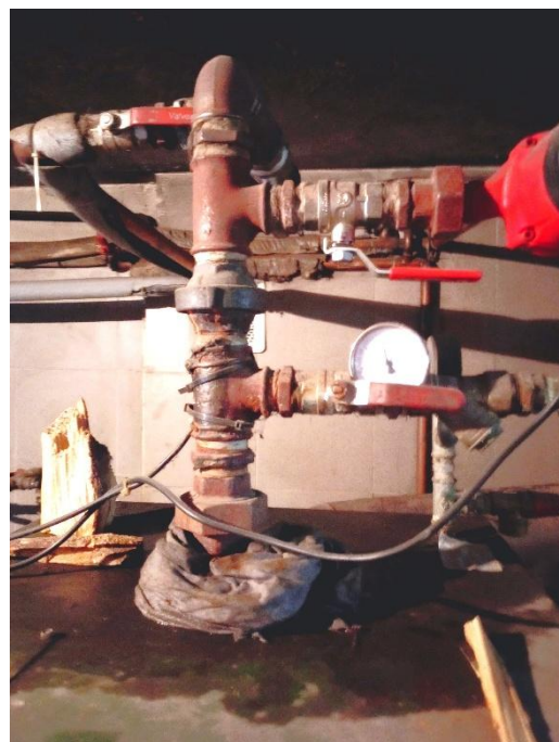
Fot. 3 instalacja centralnego ogrzewania przy kotle na paliwo stałe
