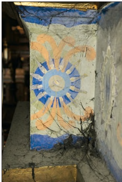
5. Lublin, kościół św. Jakuba – fragm. dekoracji przed pracami, fot. M. Burzak, 2015
