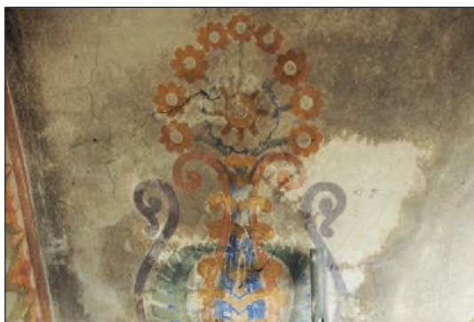
4. Lublin, kościół św. Jakuba – fragm. dekoracji przed pracami, fot. M. Burzak, 2015
