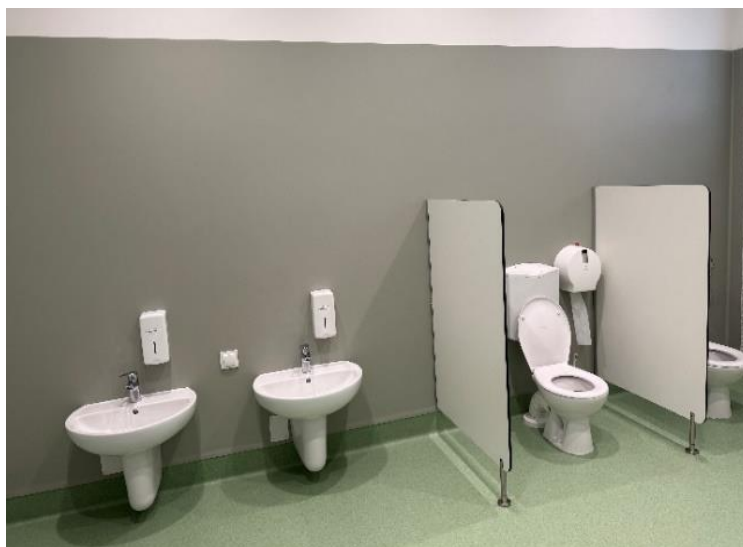
Zdjęcie 18. Pomieszczenie higieniczno-sanitarne w nowopowstałym Publicznym Żłobku „Kolorowy Zakątek” w Chwałowicach
