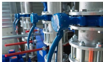
Instalacje wodno- kanalizacyjne
