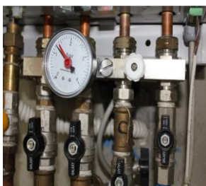
Urządzenia podgrzewające wodę użytkową
