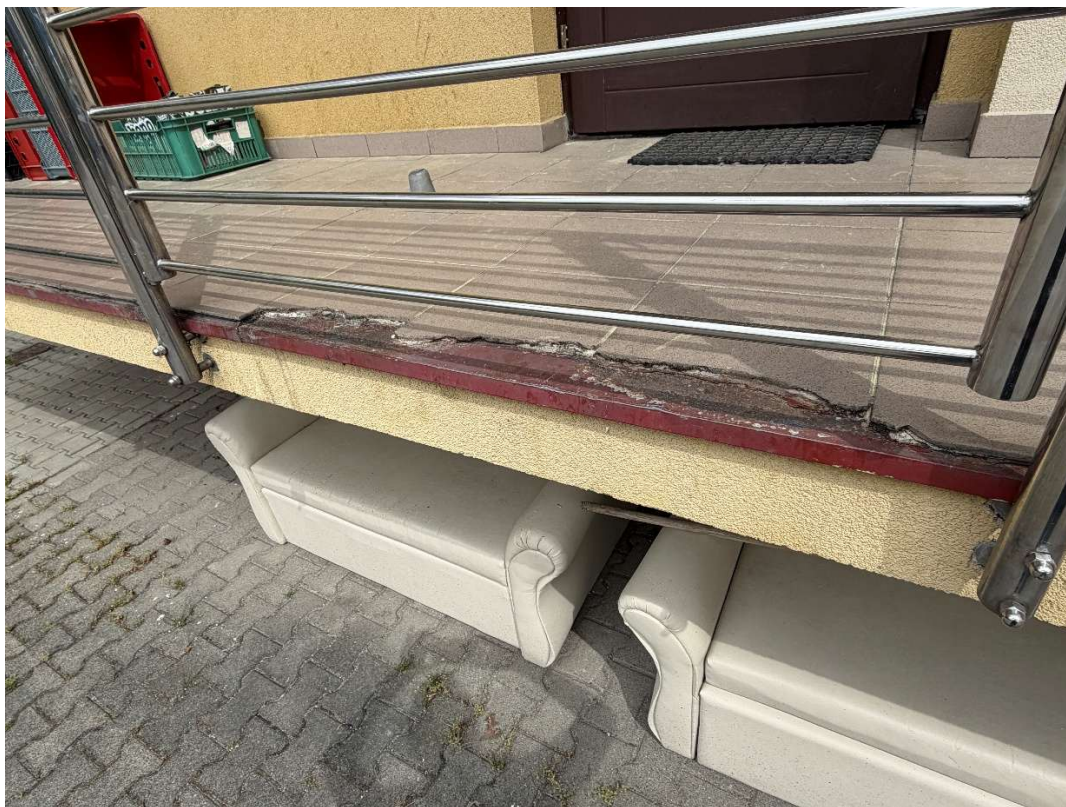
Zdj. nr 2 – widok krawędzi balkonu z uszkodzonymi, wyszczerbionymi płytkami
