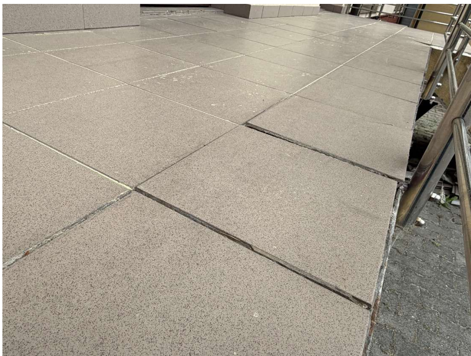
Zdj. nr 4 – odspojone płytki na balkonie
