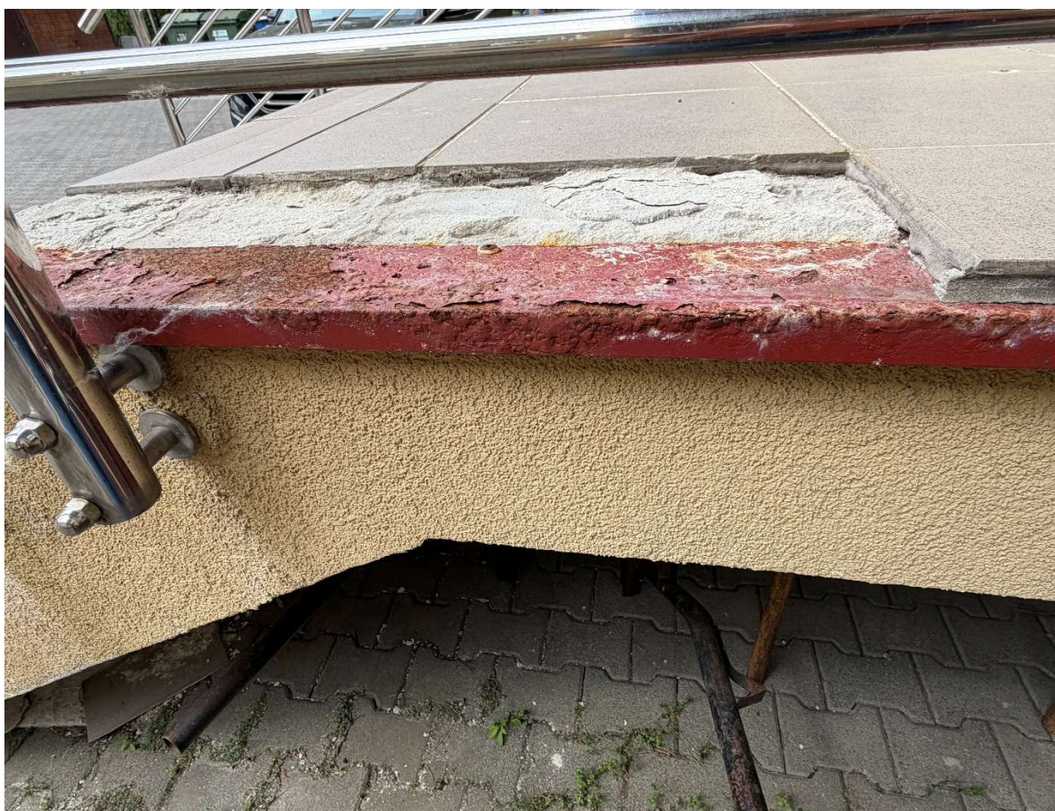
Zdj. nr 8 – zardzewiała obróbka płyty balkonowej
