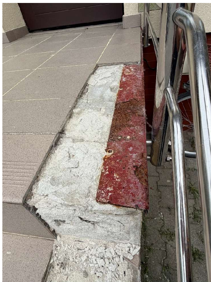
Zdj. nr 5 – brak płytek i odsłonięta obróbka blacharska płyty balkonowej
