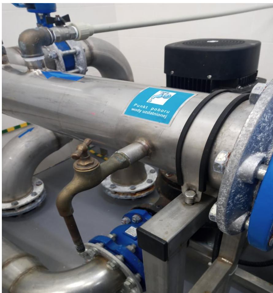
Kran do poboru próbek wody, Źródło: PSSE Zielona Góra
