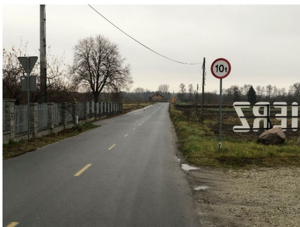
Zdjęcie nr 3 – brak znaku B-18 po prawej stronie ulicy oraz przekrzywiony znak D-42
