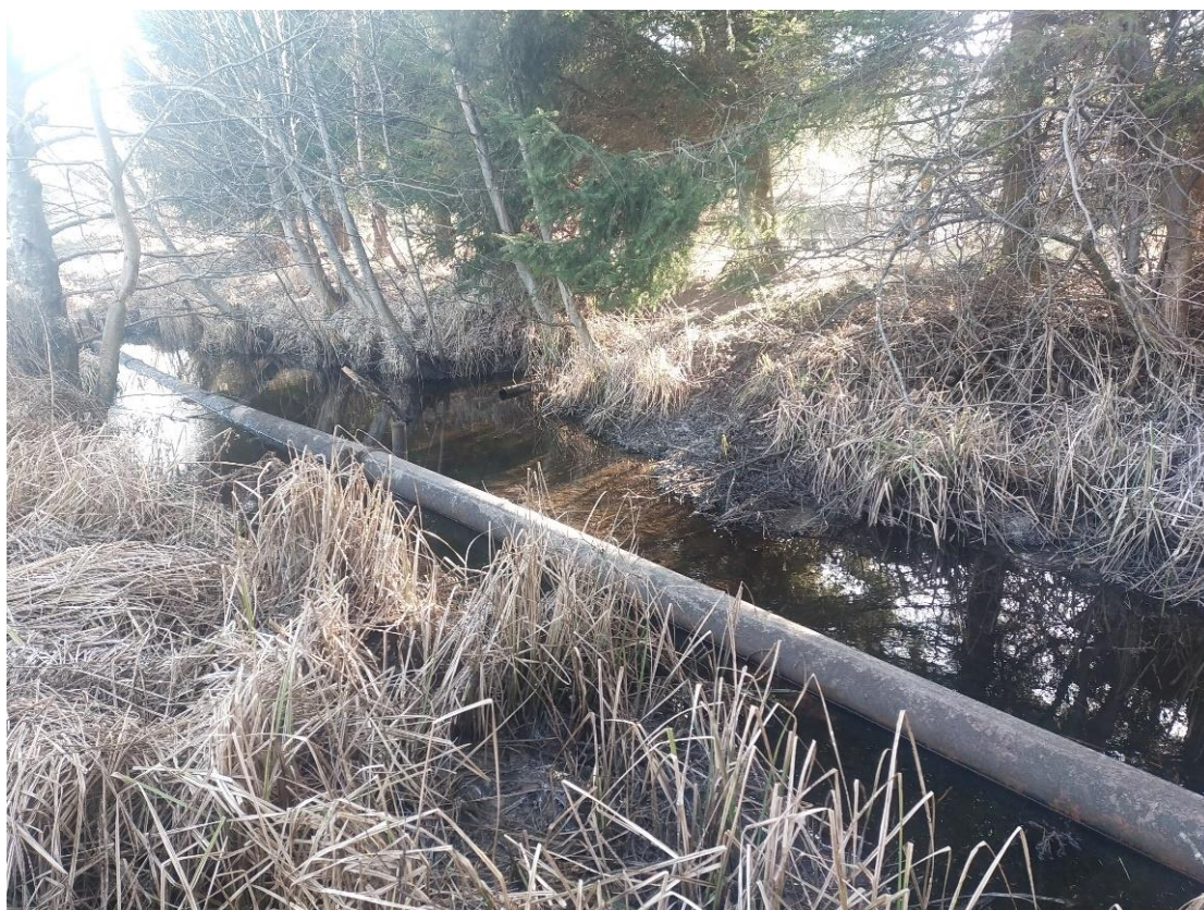
Fot. 3. Rura przelewowa nr 2
