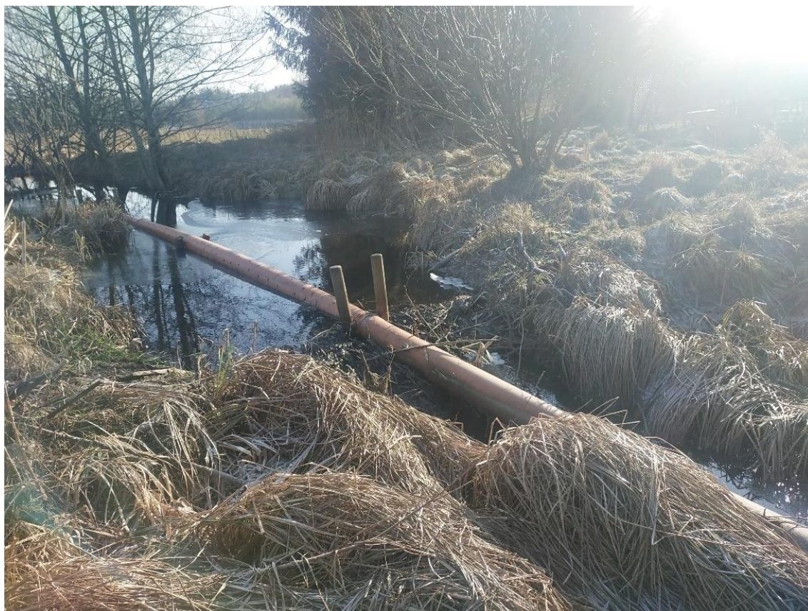
Fot. 4. Rura przelewowa nr 3
