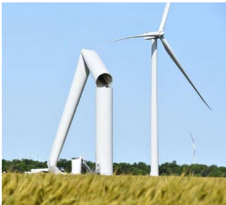
Rys. 1.33. Katastrofa konstrukcji wieży turbiny wiatrowej – materiały PSEW.
