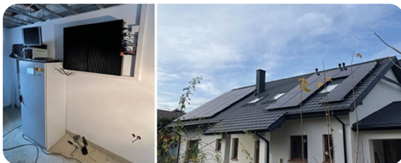
Systemy magazynowania energii
