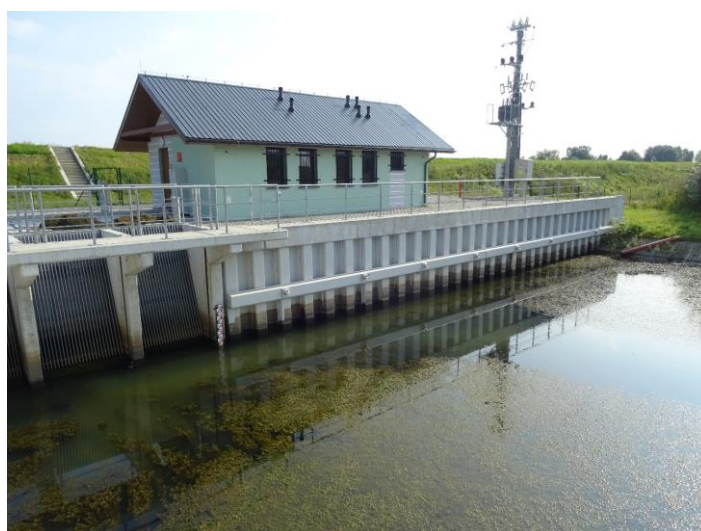
Przepompowni wody w msc. Szewce
