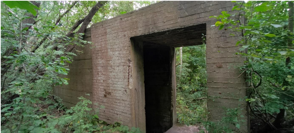
Fot. 1a. Wejście i otoczenie obiektu P1 przed zakratowaniem
