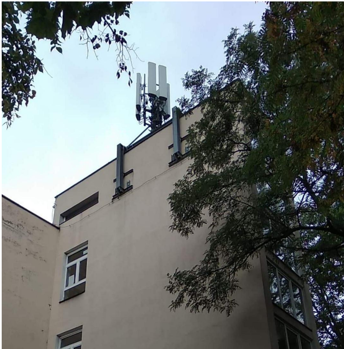
Fot. 1: Widok anten stacji bazowej ID: 70414N!, zlokalizowanej przy ul. Przełajowej 4 w Poznaniu
