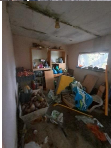
Zawilgocenia na sufitach i uszkodzenia dachu
