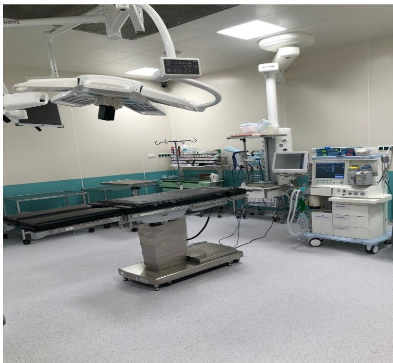
Zdjęcie: Blok Operacyjny GCZD im. św. Jana Pawła II w Katowicach ul. Medyków 16
